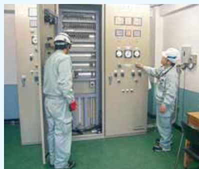
ポンプ操作中
